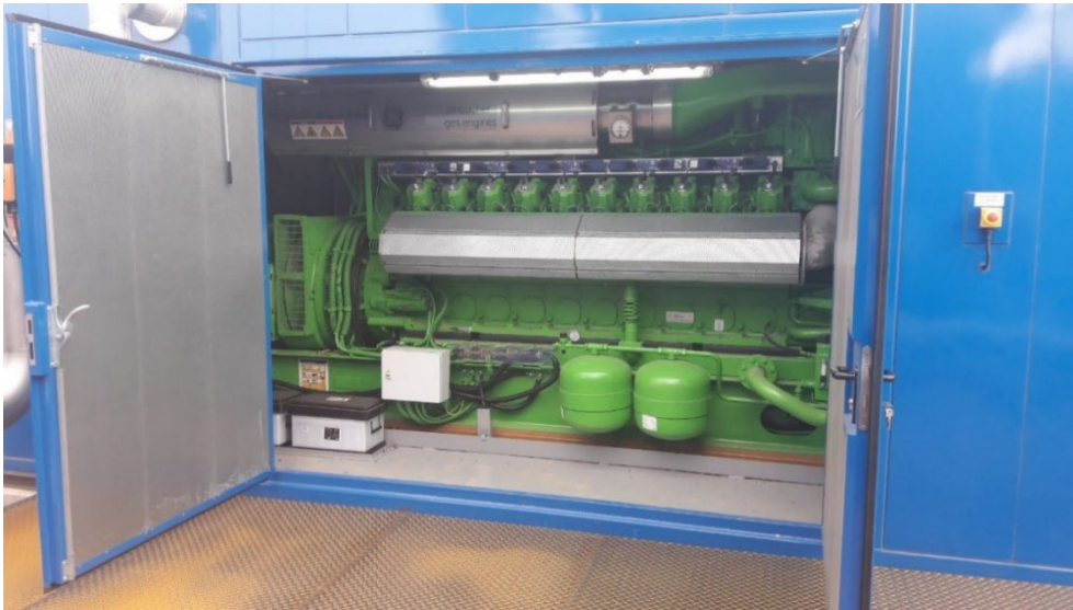
Figure 3 : Vue de l'intérieur du compartiment moteur du module de production d'électricité
